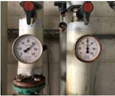
Warmwasserleitungen für die Fernwärme
